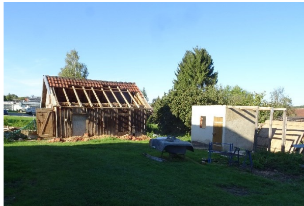
Die beiden alten Schuppen im hinteren Grundstücksteil waren ebenfalls schon teilweise abgebaut worden.
