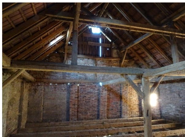
Dto.; im oberen Stadelort kann man eine dauerhafte Öffnung (für den Heukran) erkennen.
